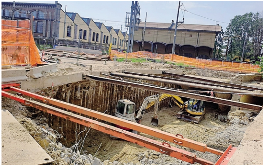
Lo su via Nino Dall'Oro: l'obiettivo è terminare i lavori entro la fine dell'anno Bagatta
