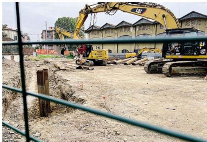
Il cantiere per la realizzazione del sottopasso fra viale Pavia e via Dall'Oro
